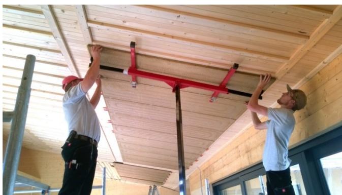
Abb1: WEM Klimadecke aus Lehm im Holzhaus
